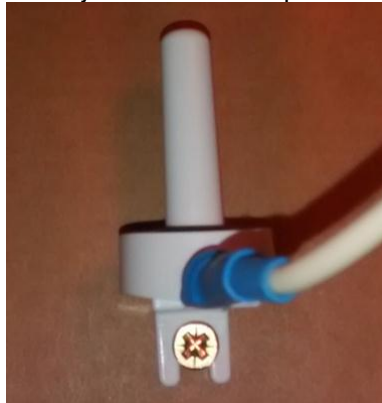
Montaje del sensor del panel solar
